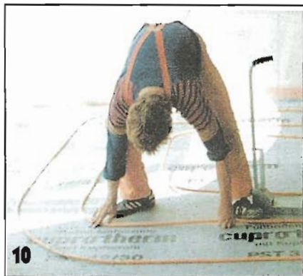
10 Прежде чем закрепить следующий участок трубы, его тщательно выставляют. Натягивать трубу ни в коем случае не следует.
